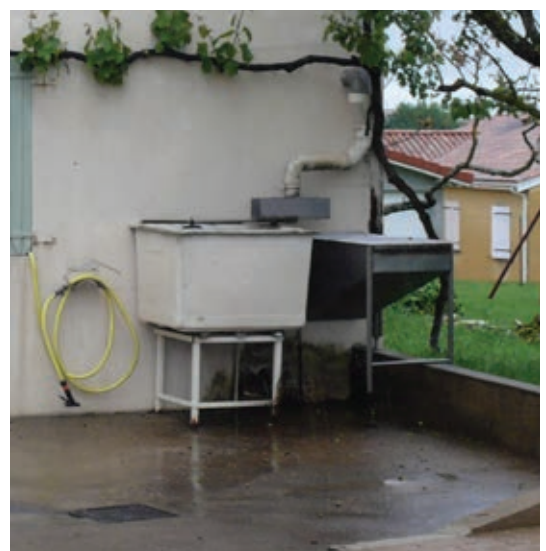
Vue des éléments : gouttière, cuve-tampon, filtre
